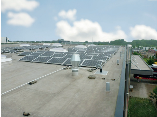
Photovoltaikanlage ADL in Amt Wachsenburg (Erfurt)
